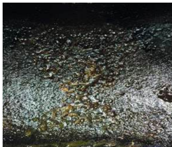
Рисунок 1. Высокотемпературная коррозия печных труб
