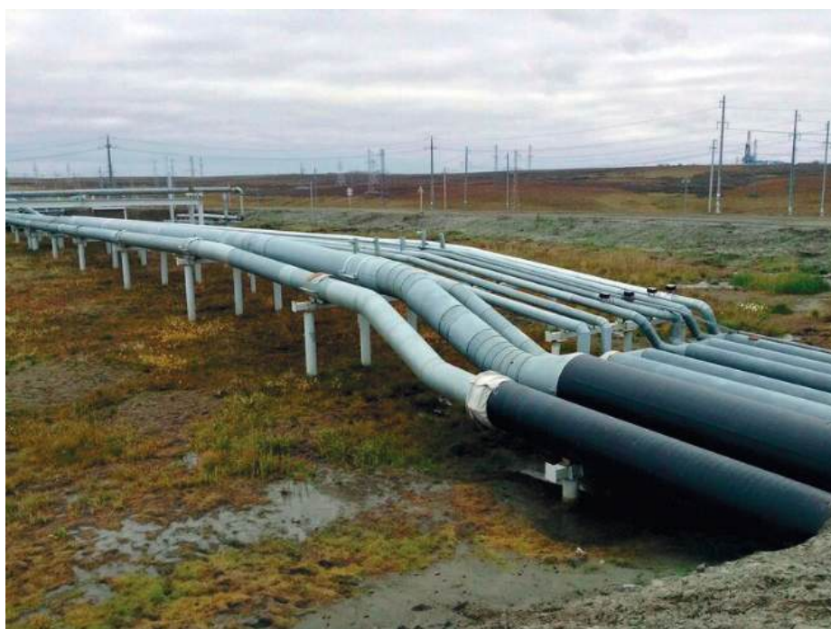
Рисунок 2. Шлейфы газосборной сети
